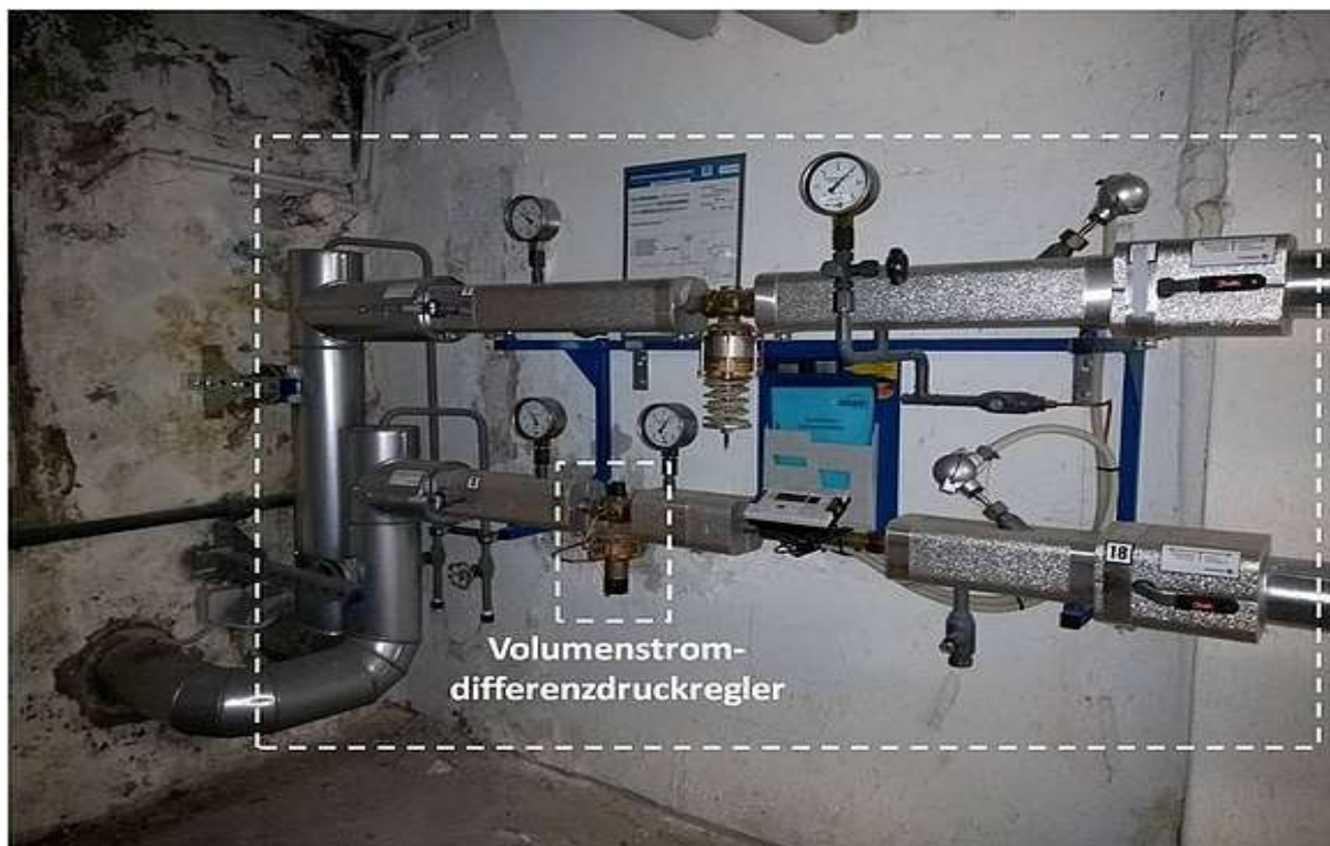
Fotografia 1. Exemplu: Stația de transfer Vattenfall din Hamburg. Debitul de apă caldă contractual este setat și sigilat în traductorul de presiune. Limita de proprietate și de responsabilitate începe după stația de transfer.
