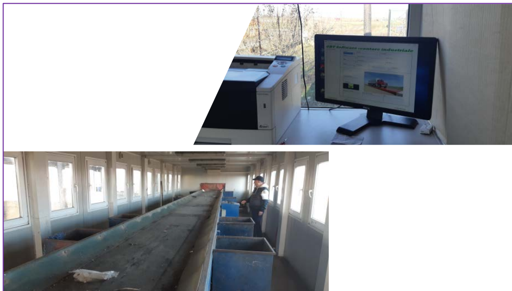
Figura 4-14: Dotări stație de sortare Drăgășani
