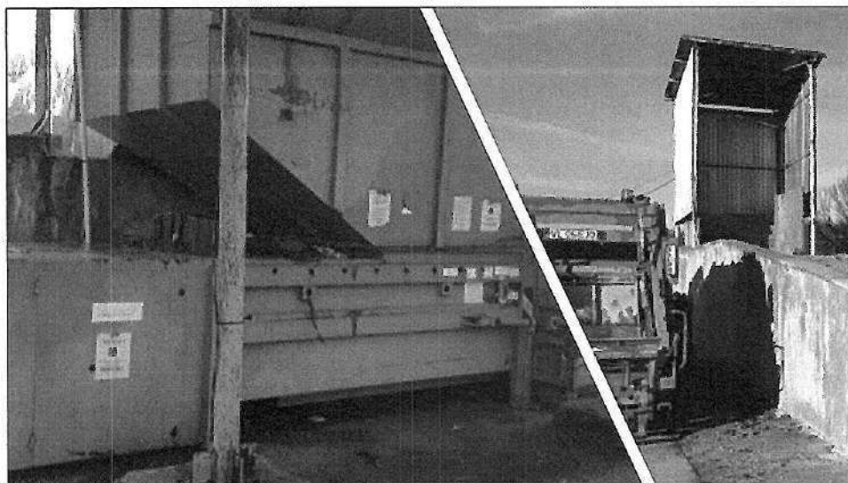
Figura 4-5: Echipamente tehnologice stație de transfer Fântățești
