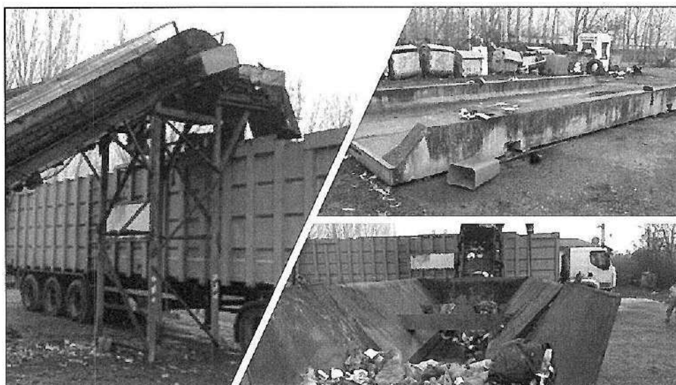
Figura 4-2: Echipamente tehnologice stație de transfer Brezoi
