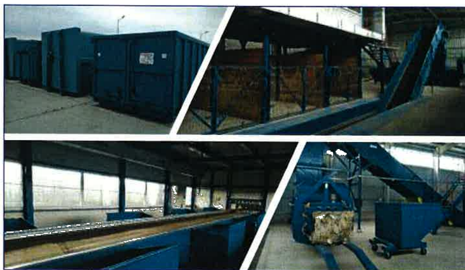
Figura 4-16: Dotări stație de sortare Râureni
