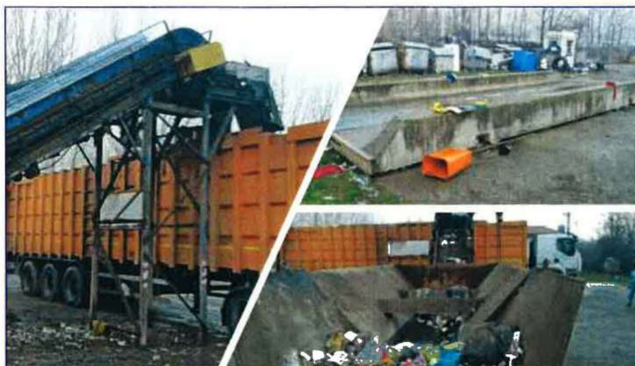
Figura 4-2: Echipamente tehnologice stație de transfer Brezoi
