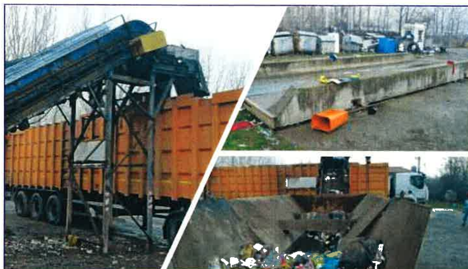
Figura 4-2: Echipamente tehnologice stație de transfer Brezoi
