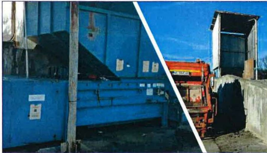
Figura 4-5: Echipamente tehnologice stație de transfer Fântățești
