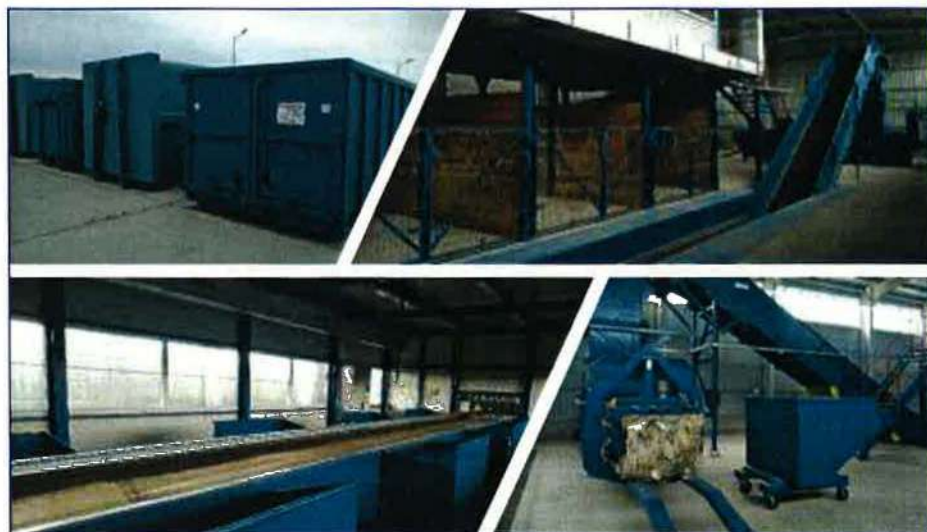
Figura 4-16: Dotări stație de sortare Râureni
