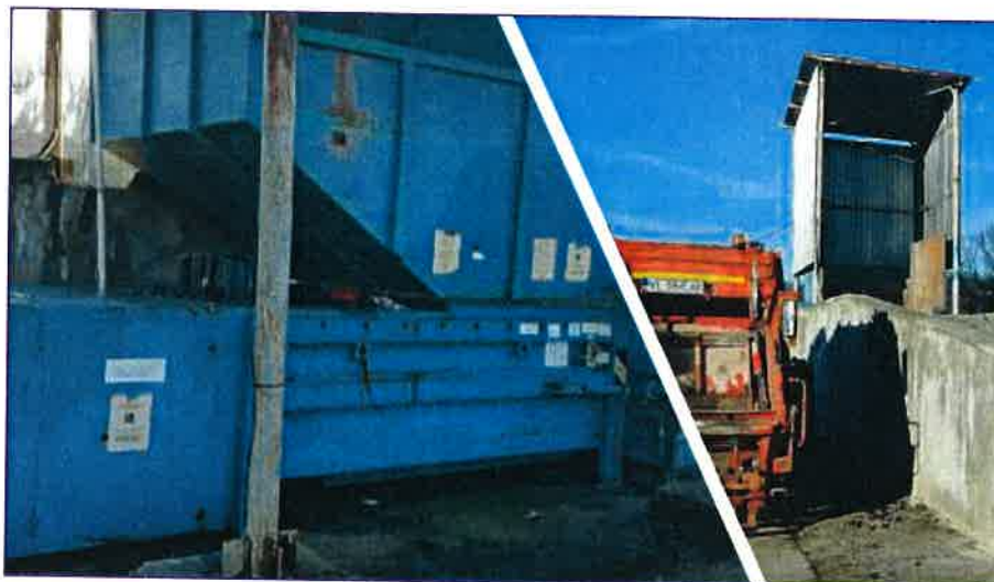
Figura 4-5: Echipamente tehnologice stație de transfer Fântățești
