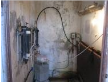
Instalatie de clorinare veche
