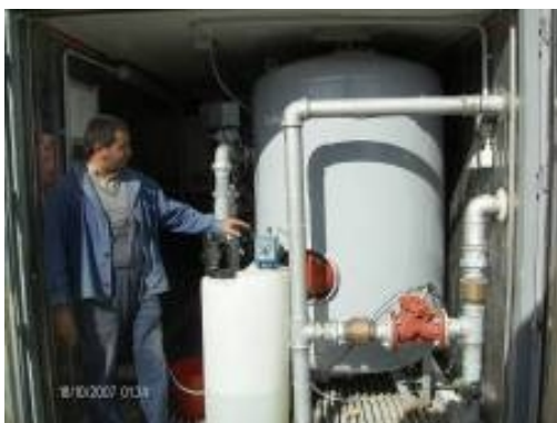
Statie de tratare a apei - Filtre
