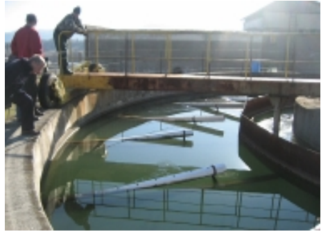
Rezervor de sedimentare (floculare)
