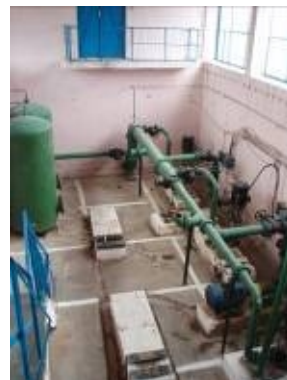
Pompe instalate in anul 2002
