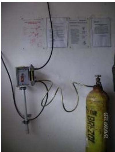
Instalatia de clorinare
