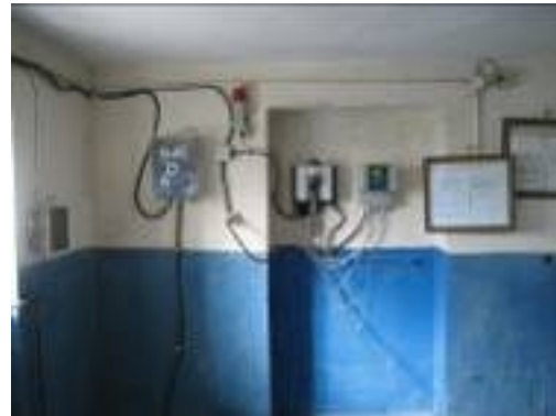
Noua instalatie de clorinare din 2002
