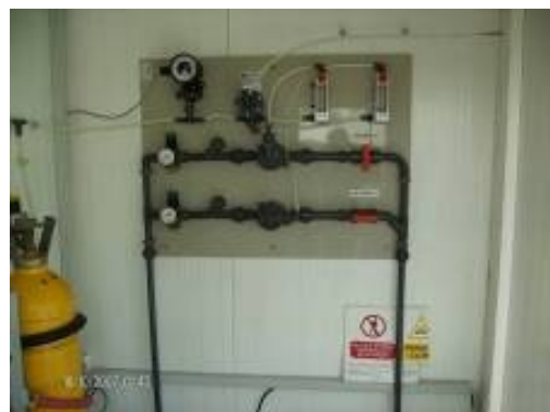
Echipament de Clorinare
