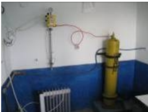
Noua instalatie de clorinare
