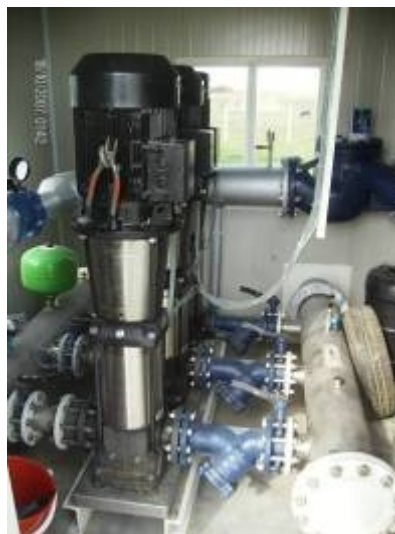
Statii de pompare – Retea
