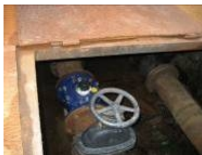
Noul debitmetru instalat
