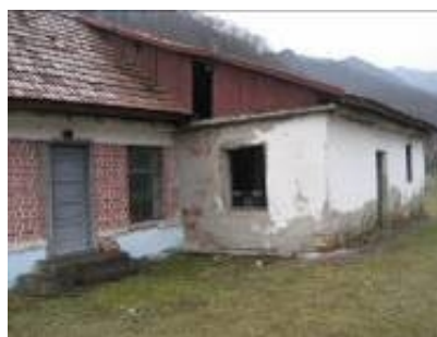
Cladire ce necesita reabilitare
