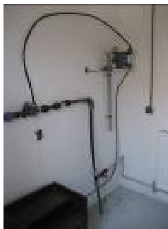
Noua instalatie de clorinare
