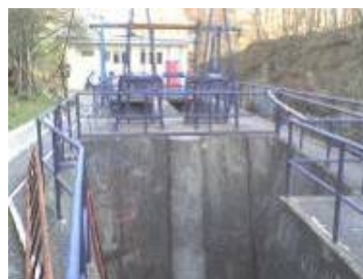
Instalatie de tratare la priza de apa
