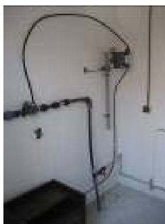
Noua instalatie de clorurare
