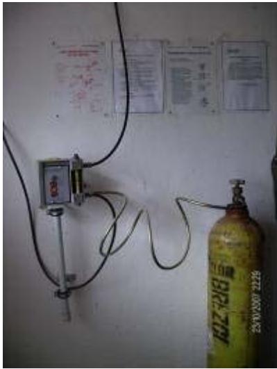
Instalatia de clorurare
