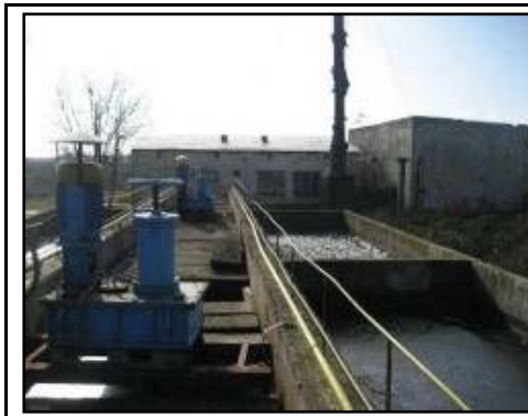
Figura 2.10-21: Rezervor de aerare
