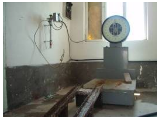
Instalatia de clorurare
