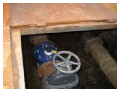
Noul debitmetru instalat
