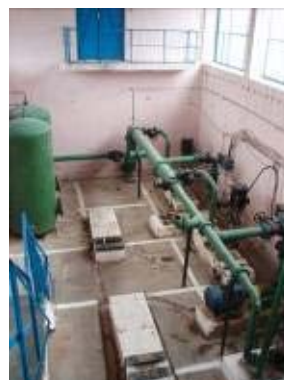
Pompe instalate in anul 2002
