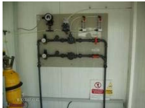
Echipament de Clorurare
