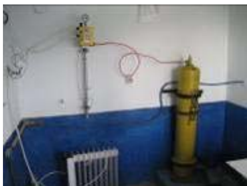
Noua instalatie de clorurare
