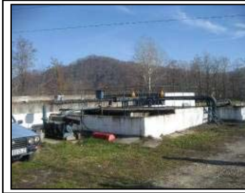
Figura 2.10-27: Rezervor de depozitare a nămolului
