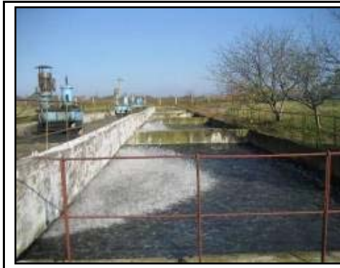
Figura 2.10-19: Rezervor de aerare
