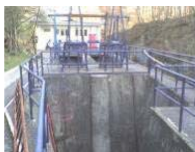
Instalație de tratare la priza de apă
