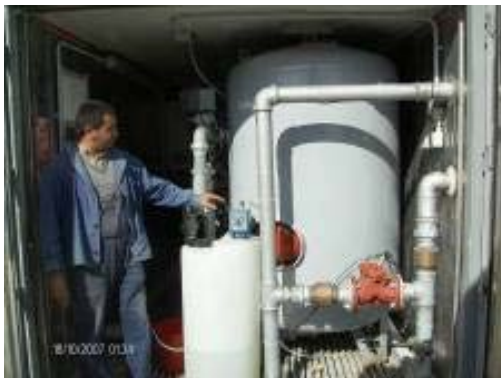
Statie de tratare a apei - Filtre
