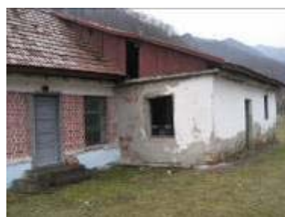
Cladire ce necesita reabilitare
