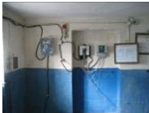
Noua instalatie de clorurare din 2002
