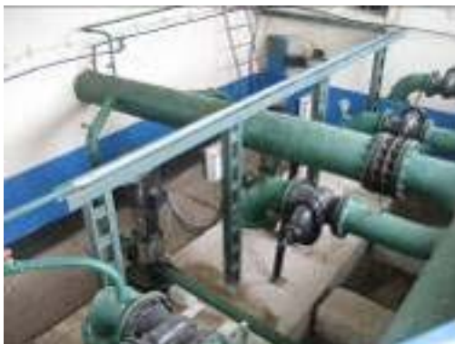
Rudari – Pompe instalate in anul 2002
