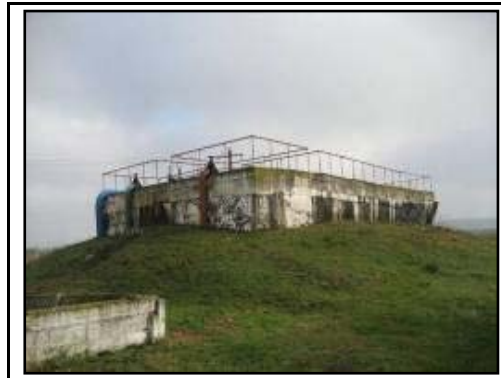
Figura 2.10-14: Rezervor de aerare
