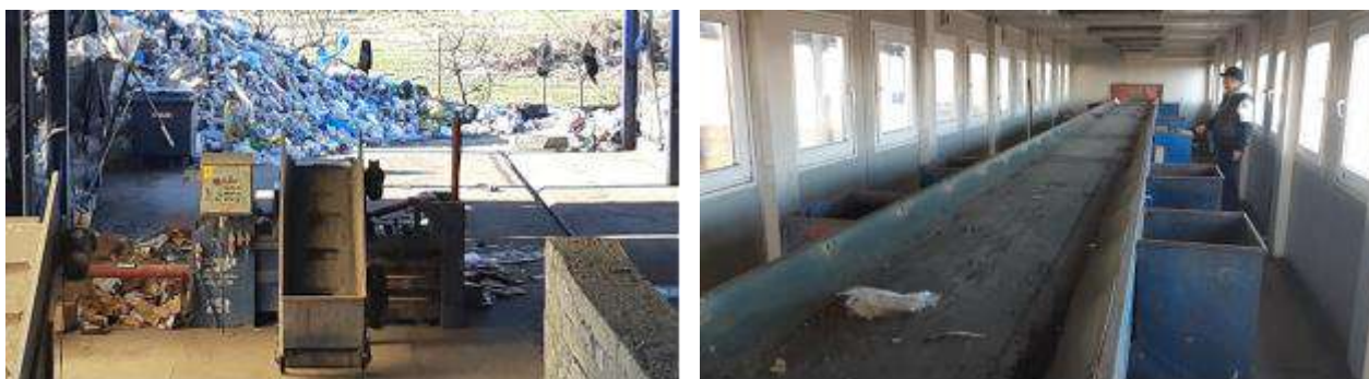
Figura 3.51. Stația de sortare a reciclabilelor Drăgășani
